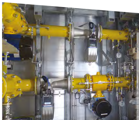
Einblick in die Anlage zur Einspeisung von Wasserstoff in das Erdgas-Verteilnetz im Freiburger Industriegebiet Nord. Dort betreibt das Fraunhofer ISE ein Labor und Technikum für die Wasserstoffherzeugung durch Elektrolyse.
