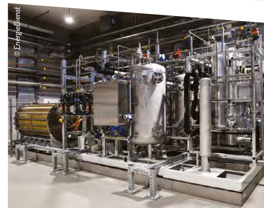
Elektrolyseur H 2 -Wyhlen. Électrolyseur de H 2 -Wyhlen.
