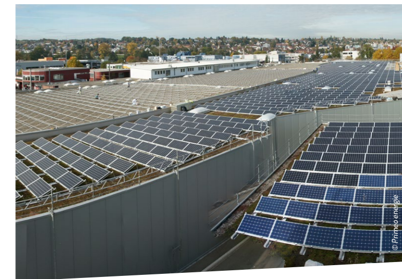
Die Photovoltaikanlage auf dem Tramdepot der Baselland Transport AG zählt mit einer Leistung von 1,17 MWp zu den größten in der Nordwestschweiz.
