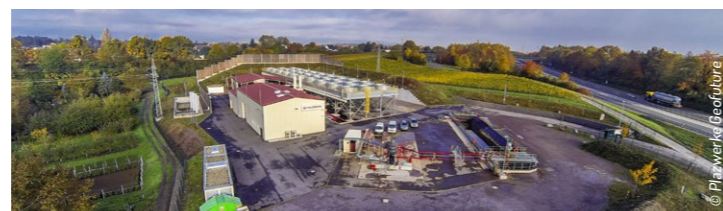
Das Geothermiekraftwerk der Pfalzwerke geofuture GmbH im südpfälzischen Insheim. La centrale géothermique des Pfalzwerke geofuture à Insheim, dans le Palatinat du Sud.
